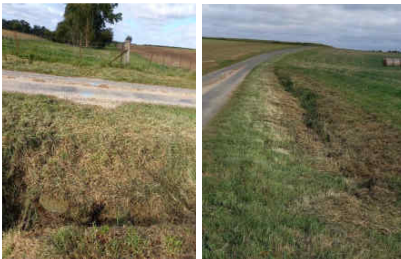
Figure 36 : Buse recueillant les eaux de ruissellement et fossé associé, Photos : F. Huchin – Ecosphère
